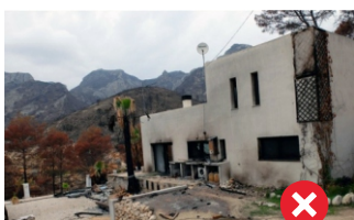
Vegetació massa a prop de la façana.
