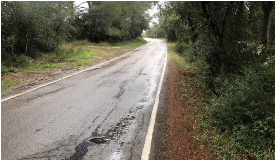
Fotografia 18: Alternativa 2 – Punt d'entroncament entre la carretera actual i el traçat proposat. PK 0+920 (sentit nord).
