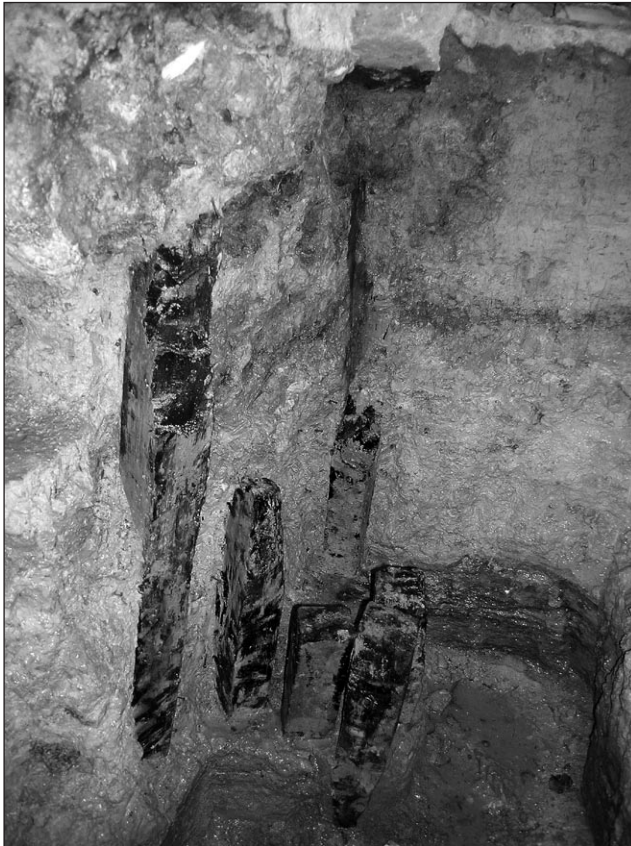
Pilonatge romà localitzat durant la construcció d'una de les sabates de fonamentació. La humitat del terreny féu possible la conservació d'aquests elements, que han permès comprovar la gran obra de fonamentació que s'hagué de fer en aquest sector per poder bastir les termes en època romana.
