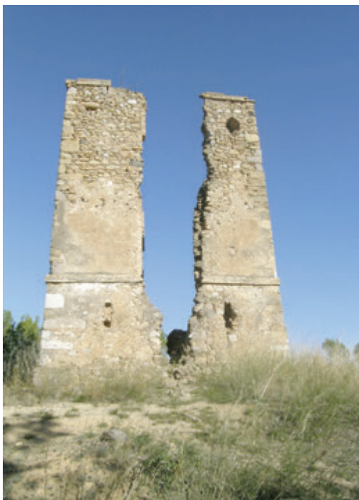
Figura 8: Vista de la torre de l'Àngel de Pontós. En el momento de iniciar la intervención la torre se encontraba abierta por sus cuatro costados, a causa de la extrema elasticidad del terreno y de la caída de los pisos interiores que la grapaban, de forma que en la imagen aparece totalmente arruinada.
