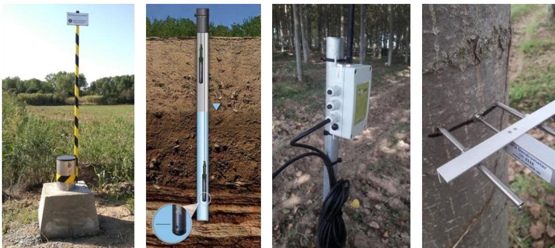
Detall de la instrumentalització al Baix Ter: arqueta exterior de piezòmetre; detall d'instal·lació del sensor de nivell a l'interior del piezòmetre; estació dels sensors d'humitat instal·lats en el sòl a diferents fondàries, i dendròmetre instal·lat en un pollancre per controlar-ne el creixement.
