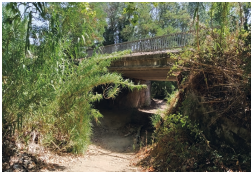
>> Estat actual del conegut com a «pont de les desgràcies», després de diverses remodelacions. (Foto: XAVIER MARTÍ)
