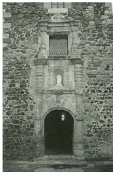
La portada de la capella es manté en bon estat de conservació.
