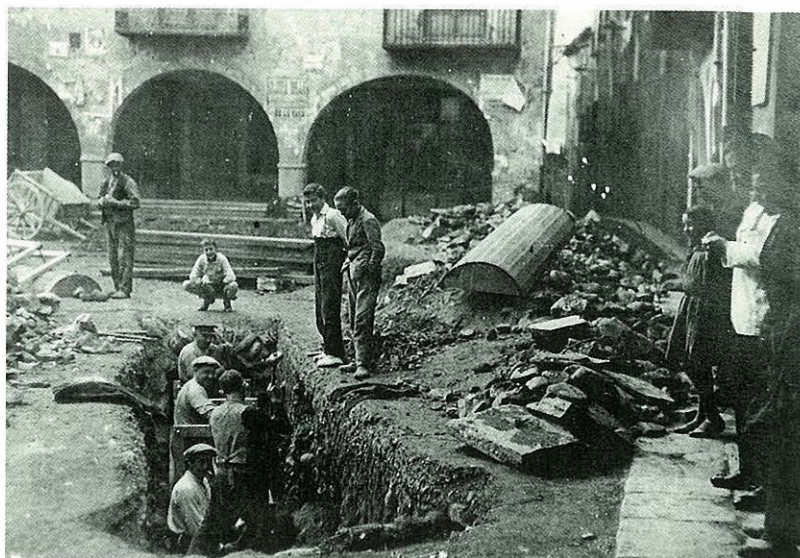
Obres de construcció del clavegueram de la plaça Major. Per tal de pal·liar l'atur, l'Ajuntament intensificà l'obra pública.
