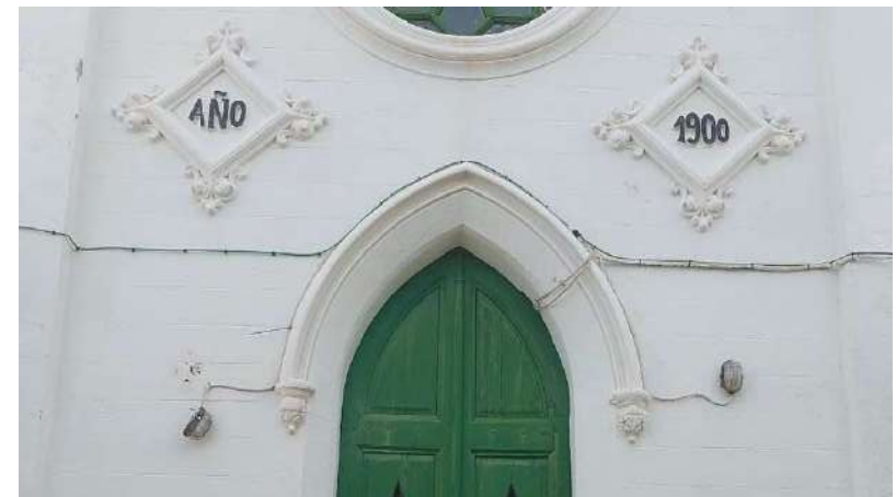
IMATGES DE L'ESTAT DEFICIENT DE LES INSTAL·LACIONS
