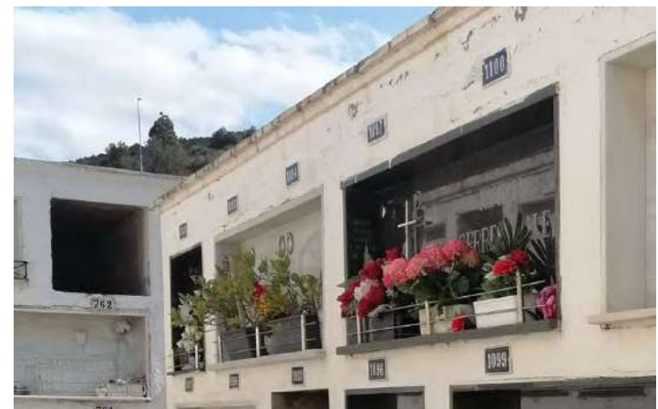
IMATGES DE LES PATOLOGIES LLEUS EN ELS PARAMENTS VERTICALS
