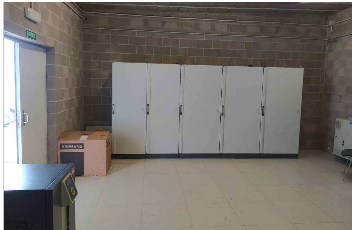
Armaris de distribució elèctrica ABB existents
