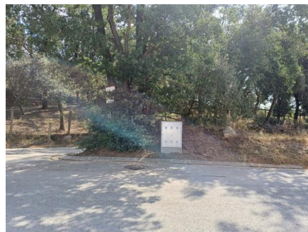
Fotografia 19. Connexió xarxa i comptador
