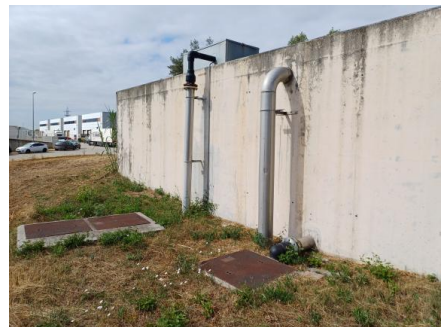
Fotografia 52. Conduccions entrada dipòsit
