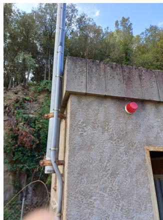
Fotografia 12. Exterior i antena
