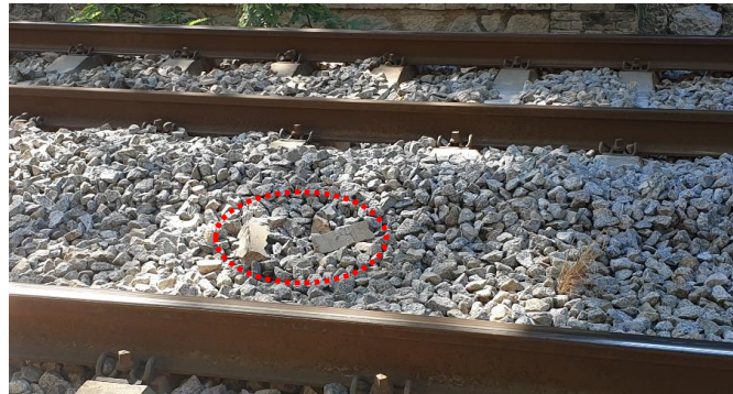
Figura 4. Trossos de formigó després sobre el balast de la via.
