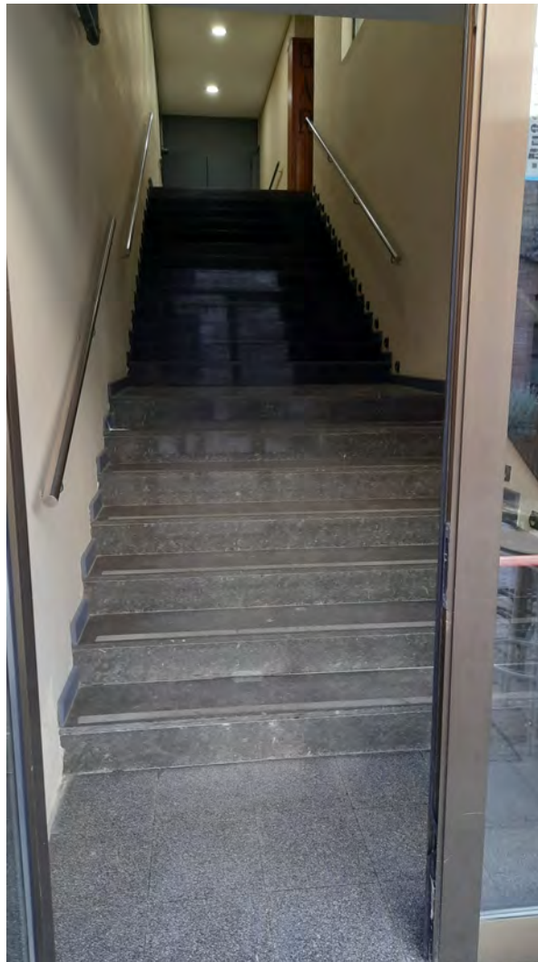
Escales d'accés al bar i a l'espai cultural, on es vol instal·lar una plataforma puja-escales
