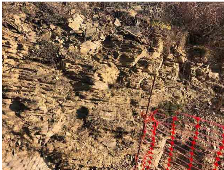
Foto 1. S'observa la alteració de la Estació geotècnica 1, on s'observa la estructura de la roca de forma continua.
