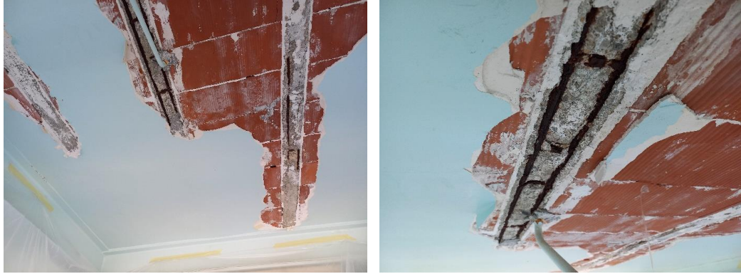
Vista interior de la zona afectada. Part inferior del forjat del menjador
