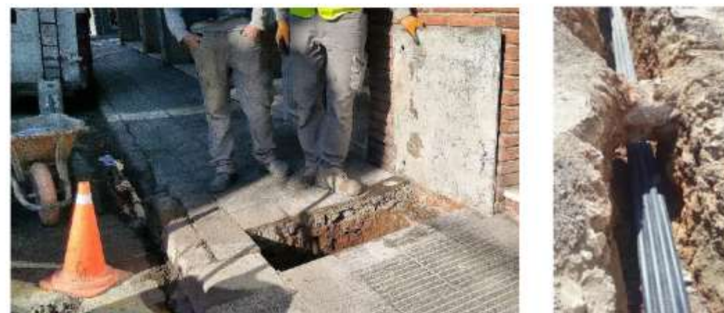
Exemple d'execució de cata amb detecció de serveis i minat de canonada
