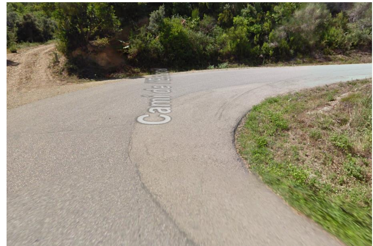
Figura 15 Creuament de carretera GI-7525 des de pericó 17007PE3013 fins a pericó I 17007PE3014
