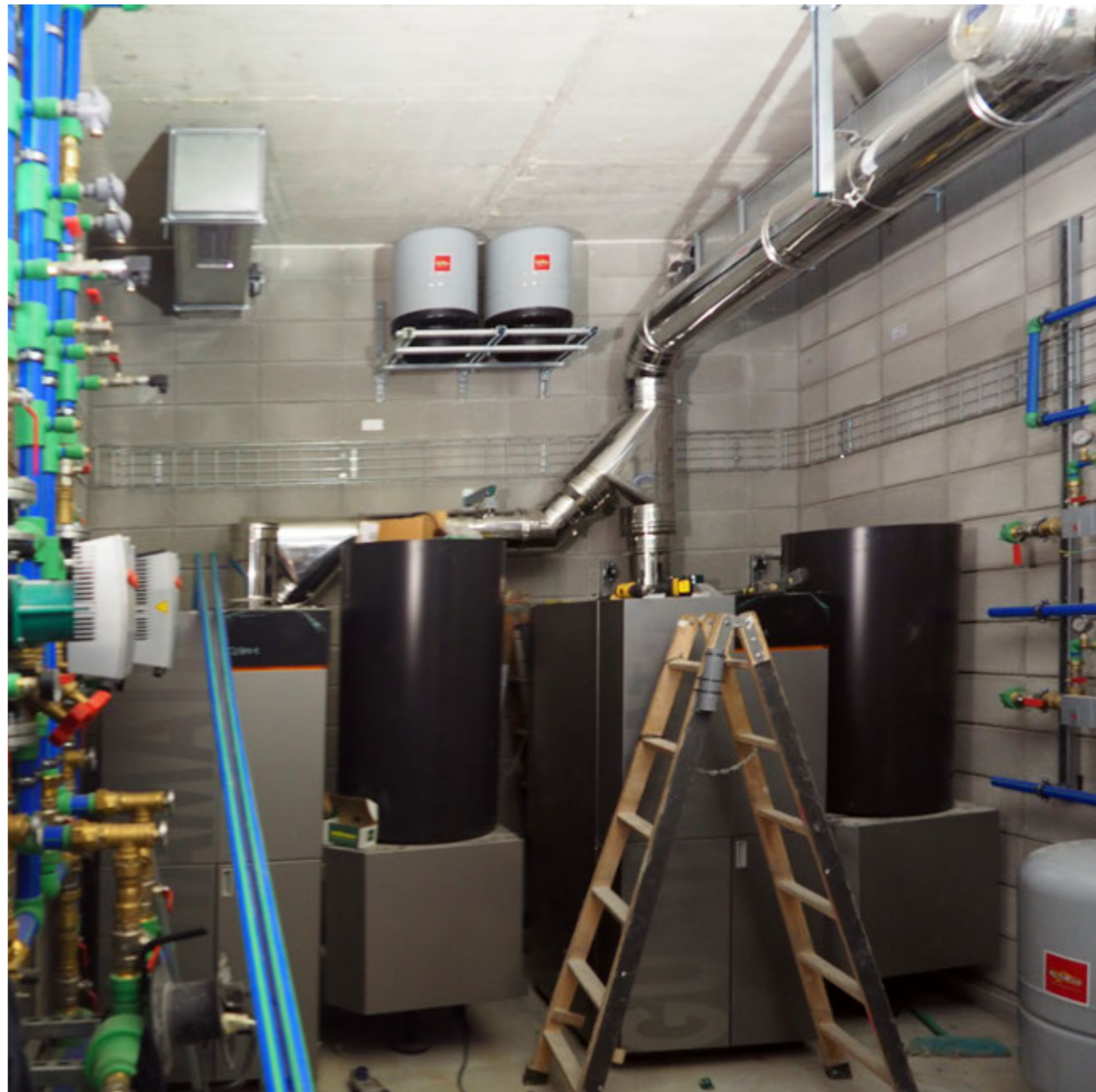
producció tèrmica renovable amb biomassa [2x45 kW + dipòsit 2500L + 300L] producció elèctrica contractada a Som Energia futura instal·lació fotovoltaica
