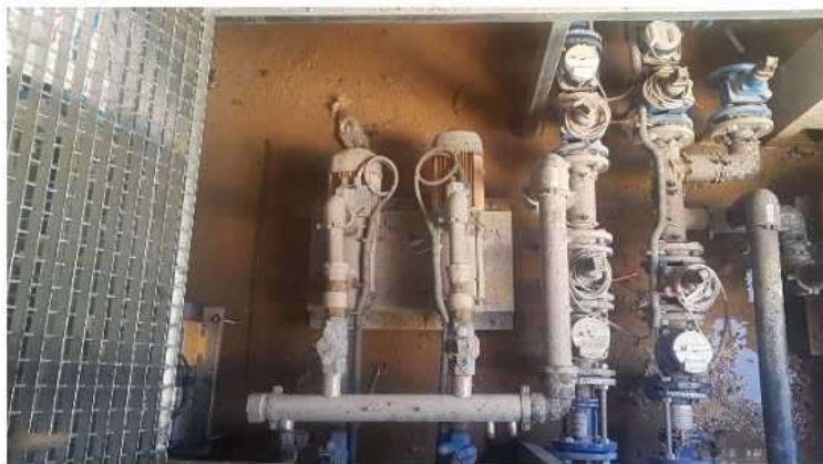
Estació de bombeig dipòsit Sant Esteve de Guialbes.
