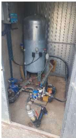
Estació de bombeig dipòsit Orfes.
