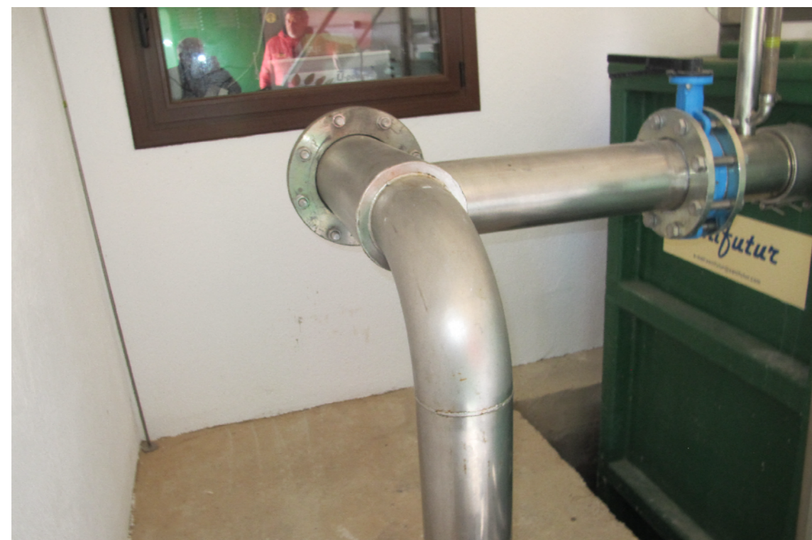
ENTRADA D'AGUA AL FILTRE
