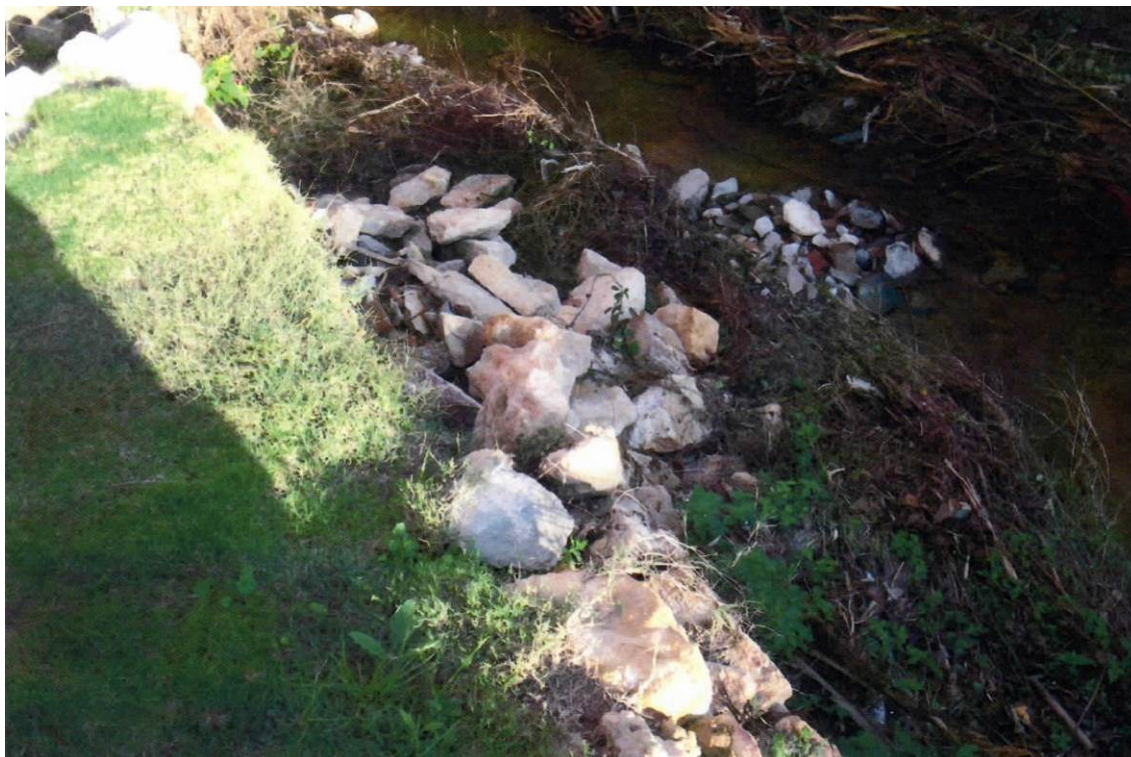
Fotografia 2: Detall dels danys soferts per un mur de contenció situat en el marge de la riera de Torrent al novembre de 2011 (punt D). Fotografia cedida per l'Ajuntament de Torrent.
