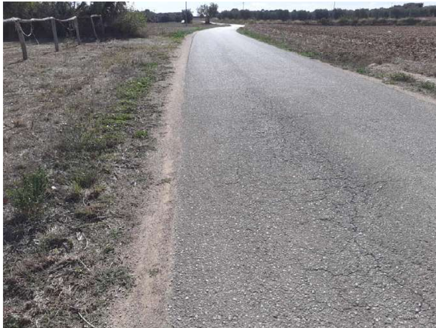
X: 499895, Y: 4672001. Paviment en mal estat
