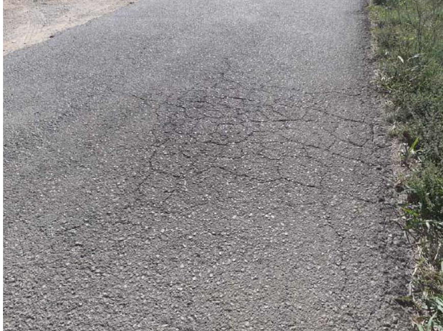
X: 499737, Y: 4672289. Paviment en mal estat
