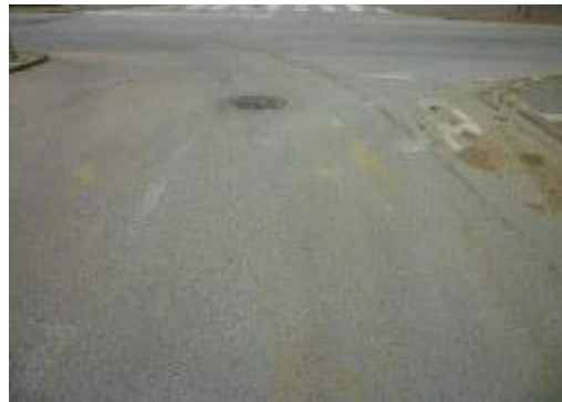
Imatge 68. Restes de la senyalització d'estop anterior a l'ordenació actual.
