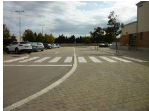
Imatge 111. Zona de plataforma única. No es veu senyal de pas de vianants
