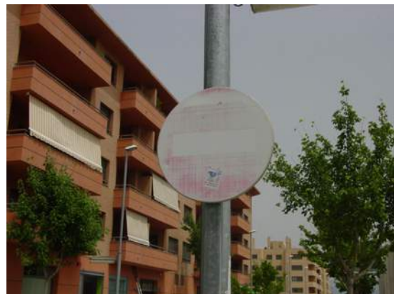
Senyal en estat deficient
