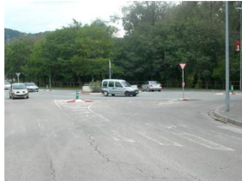
Senyalització horitzontal en estat deficient
