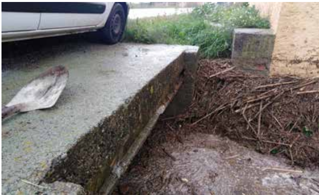
Acumulació de brossa al pont de la carretera sobre el torrent de Vall Llobrega el 18 de novembre. FOTO: JORDI ROURA
