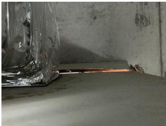
Foto: punt d'infiltració aire a la sala
