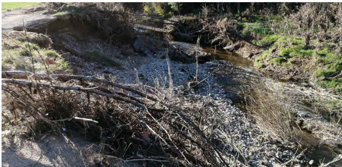
Figura 5. Detall del talús erosionat i del camí afectat del marge esquerre de la riera Bugantó a Fornells de la Selva.
