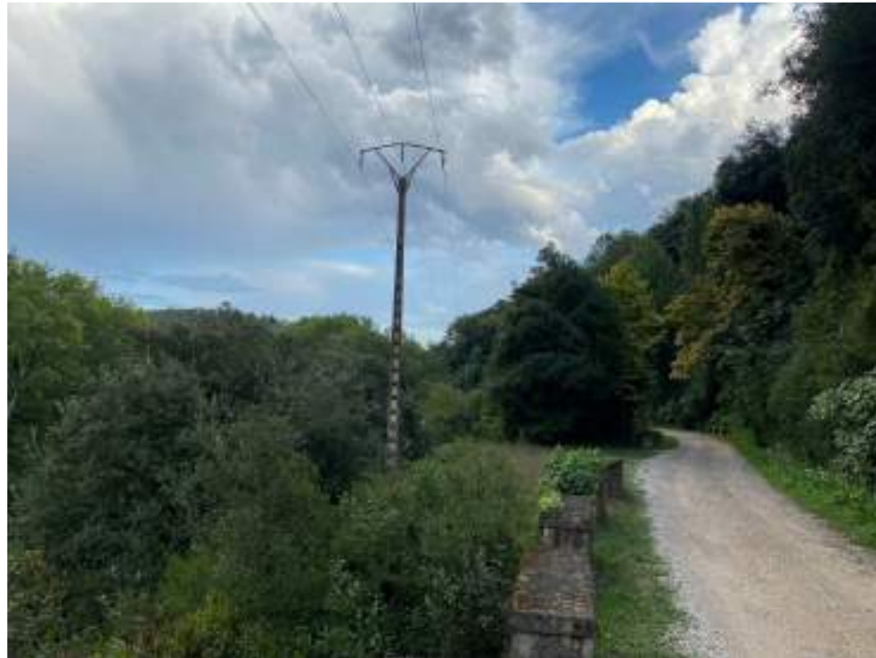
Fotografia 1. Vista actual de la línia aèria a 25 kV existent "Centrals" a retirar com a mesura compensatòria.
