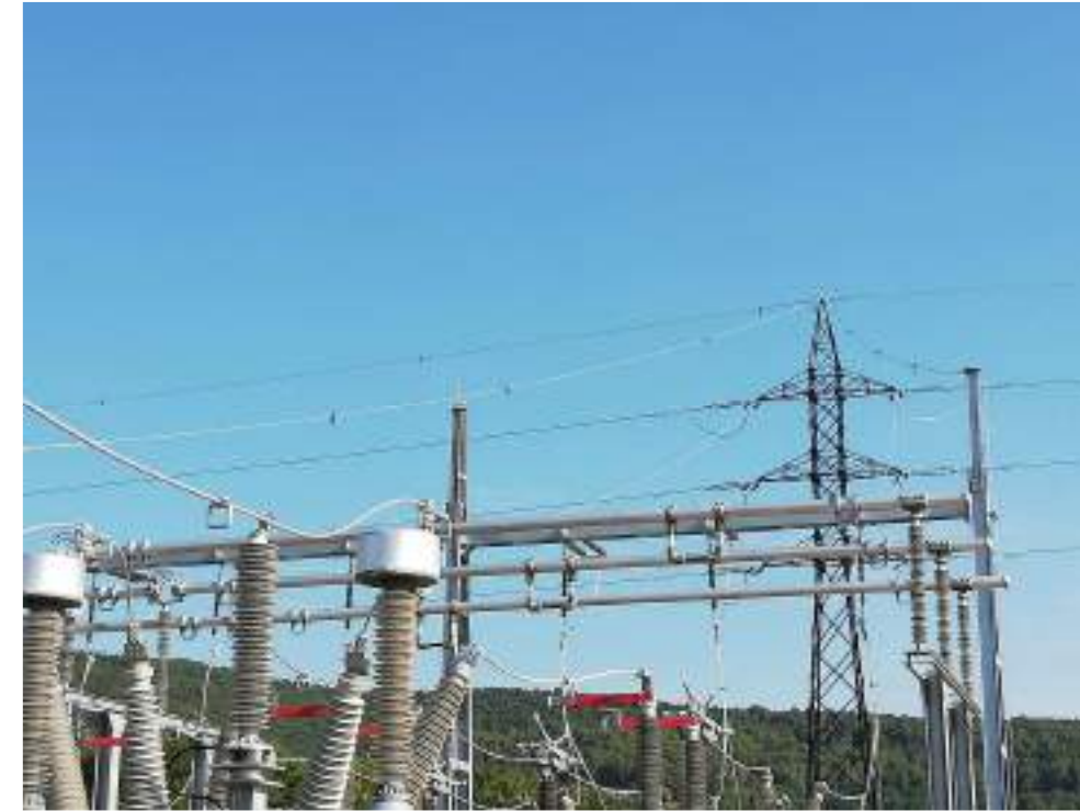
Imatge 233. Exemple de salvaocells instal·lats en una SE.
