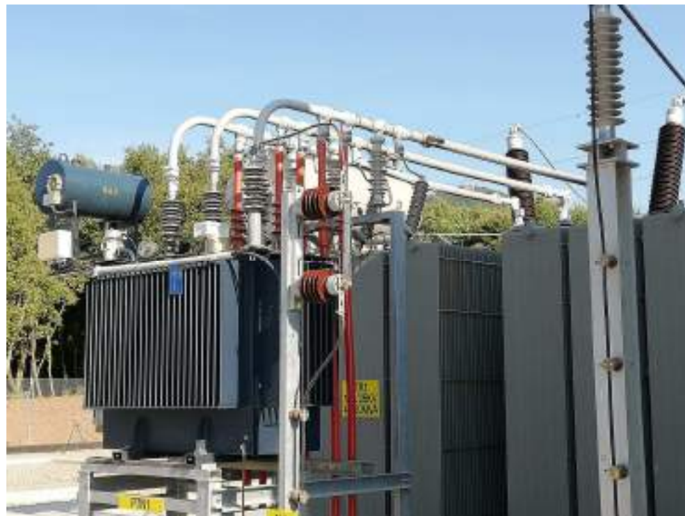
Imatge 232. Exemple de protecció per a l'avifauna dels transformadors d'una SE.
