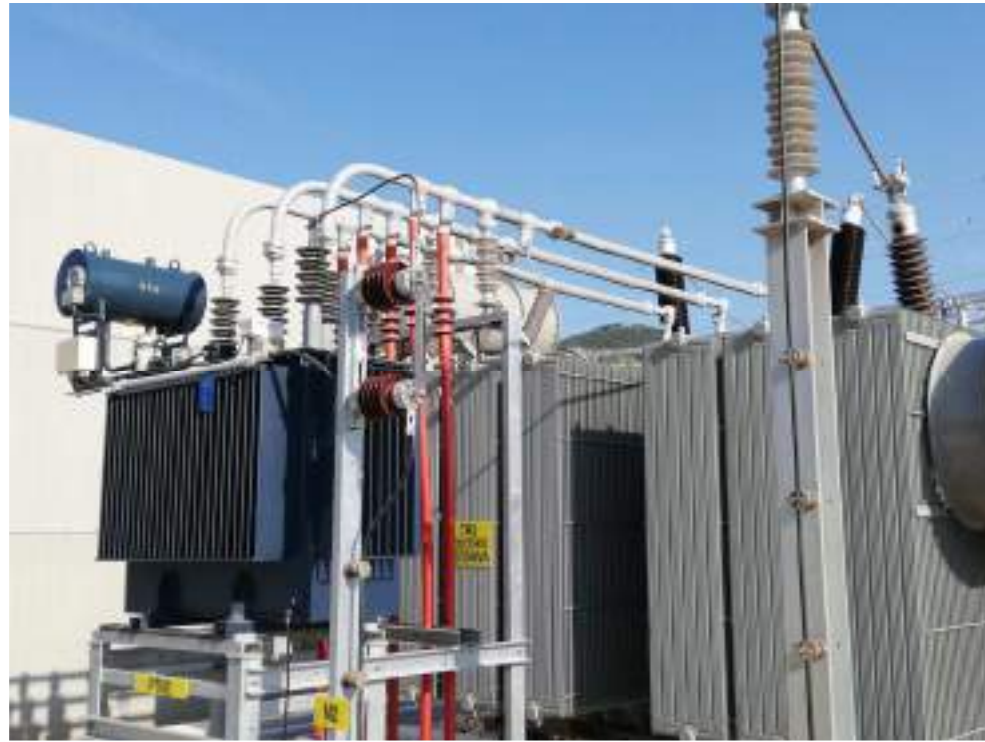
Imatge 231. Exemple de protecció per a l'avifauna dels transformadors d'una SE.
