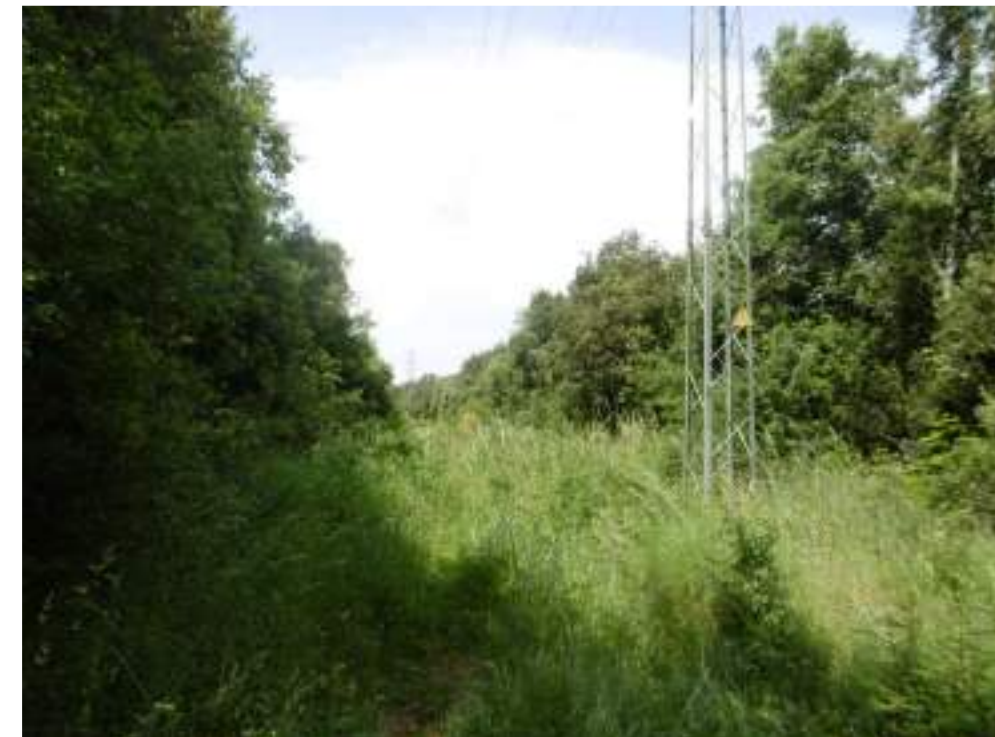
Fotografia 2. Vista actual del terreny on s'instal·laran les noves línies d'evacuació subterrànies a 25 kV, i per on es realitzarà l'accés a la nova S.E. Esponellà. Vista de la línia aèria existent a 25 kV "Serinyó".
