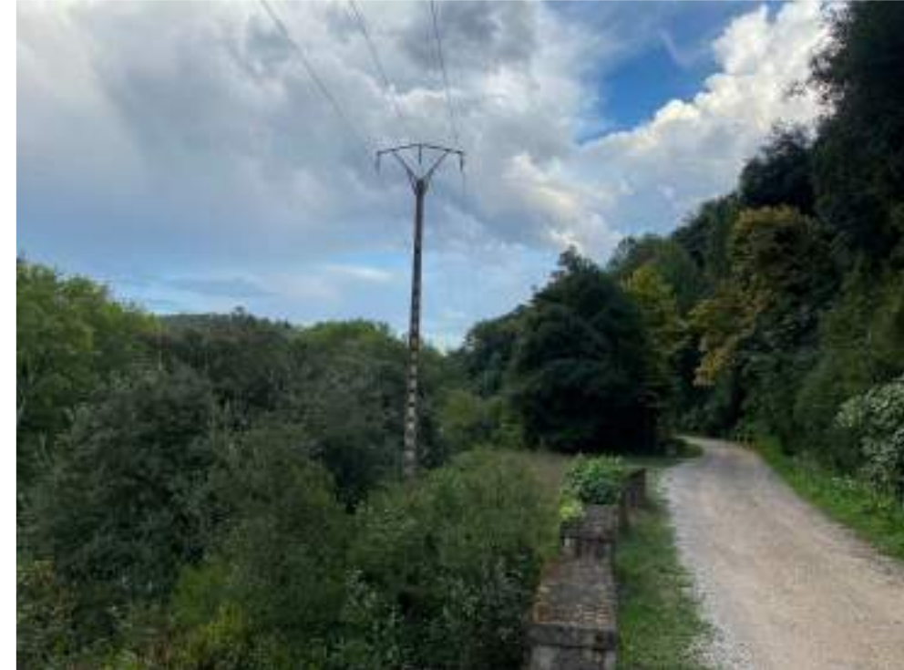
Fotografia 15. Vista actual de la línia aèria a 25 kV existent "Centrals" a retirar com a mesura compensatòria.
