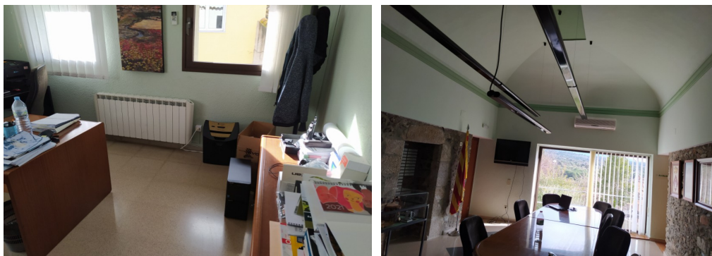
Imatge 2 i 3.- Radiadors elèctrics d'oli i bombes de calor de l'edifici de l'Ajuntament
