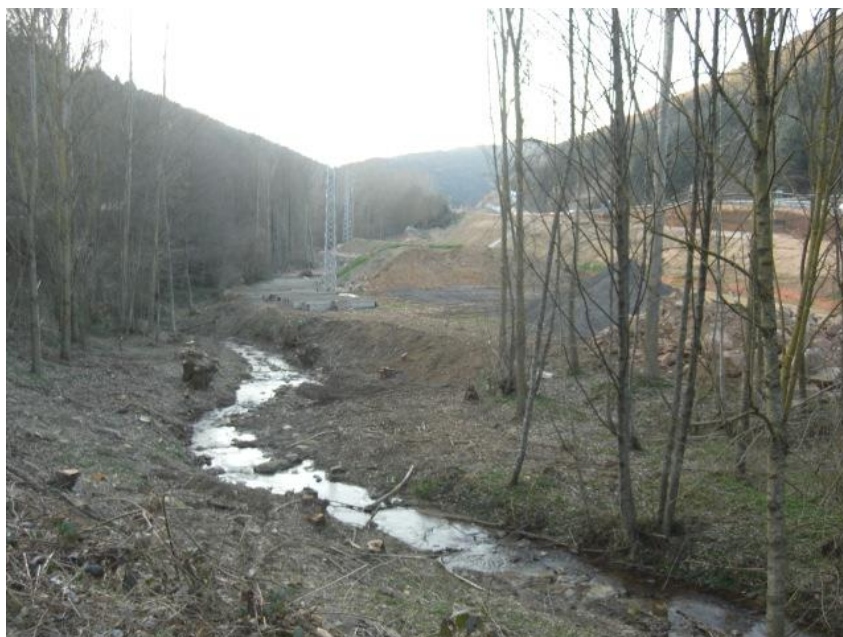
Figura 12: Vista d'un tram de riera afectada per les obres de desdoblament de la C-25
