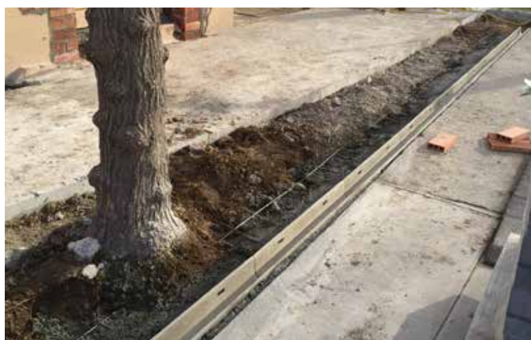
Treballs de millora a la façana sud i a l'interior del Local Social.
