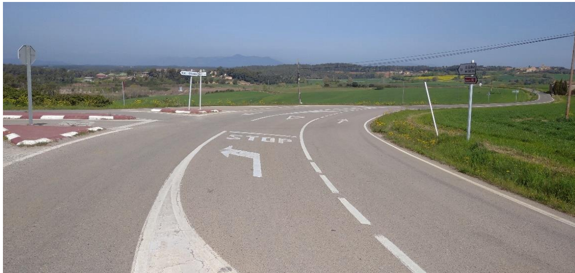
Figura 39. Imatge de l'estat actual de la intersecció al PK 1+100, en sentit Sant Esteve de Guialbes
