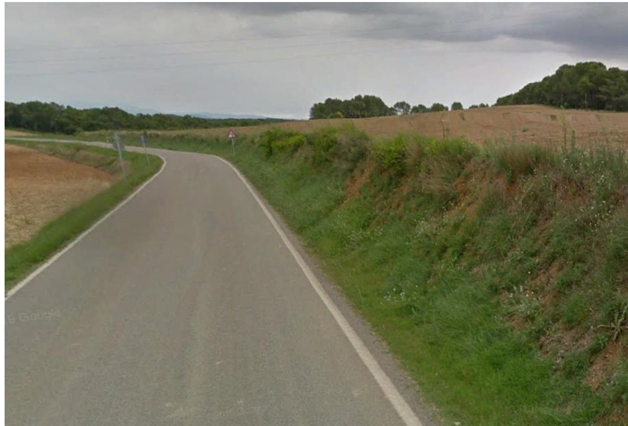
Figura 10 Cuneta de terres amb excés de vegetació
