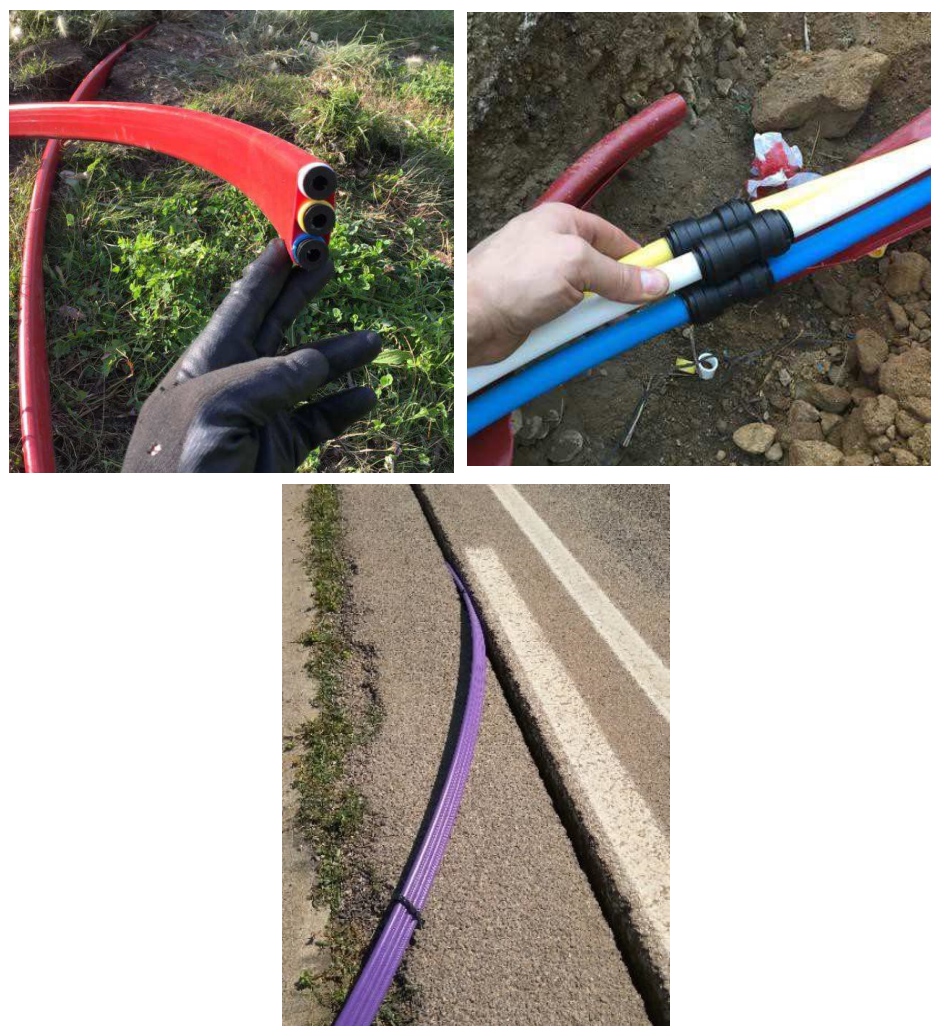
Figura 16. Microductes (3 en base 1 i 4 en base 1 o 2 respectivament)
