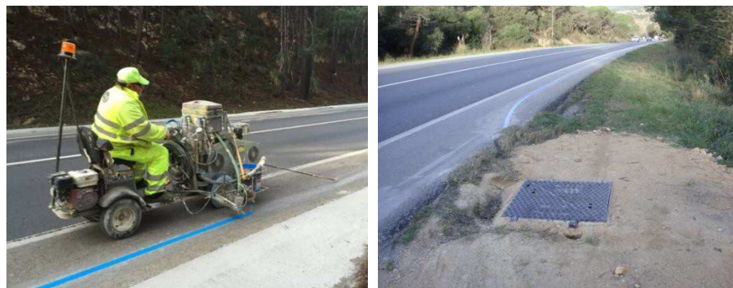
Exemple dels treballs de pintat de la línia blava Exemple de l'estat de la canalització acabada
