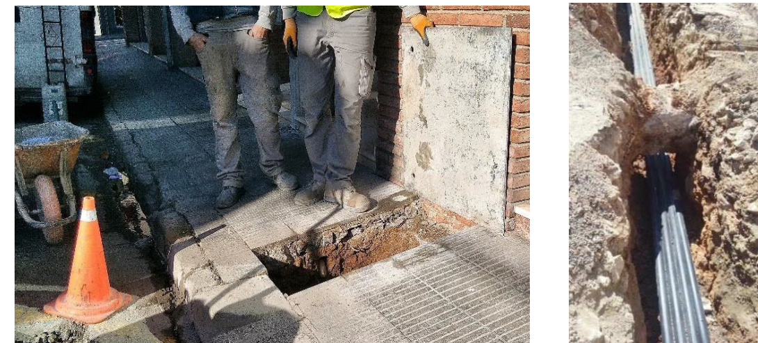
Figura 2. Exemple d'execució de cata amb detecció de serveis i minat de canonada
