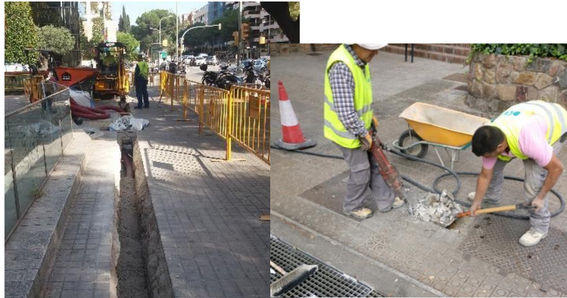
Ilustración 23. Ejemplos Canalización Convencional en ámbito municipal.
