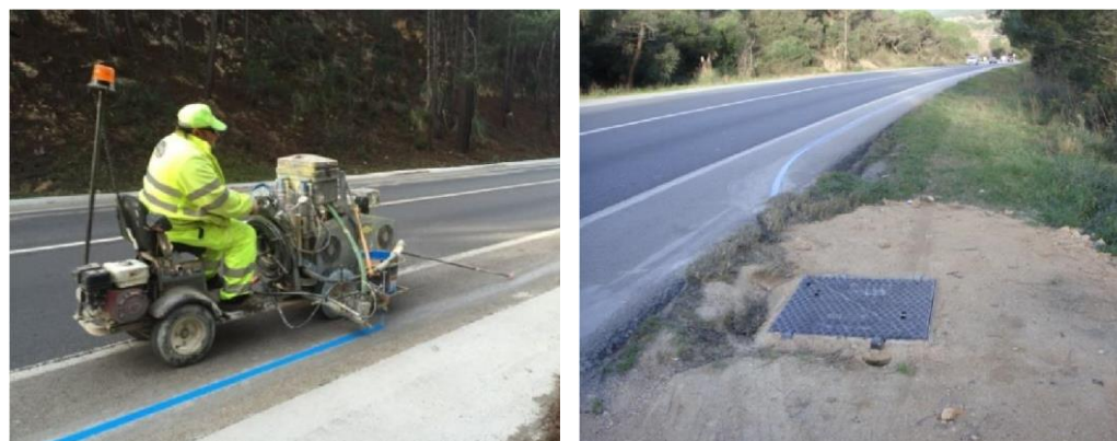
Ilustración 37. De izquierda a derecha: Ejemplo de los trabajos de pintado de la línea azul; Ejemplo del estado de la canalización terminada.
