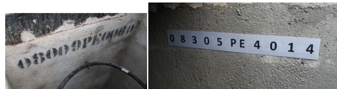
Ilustración 3. Ejemplos rotulado interior arqueta.
