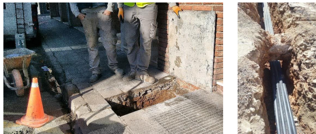
Ilustración 18. Ejemplo ejecución de calicata con detección de servicios y minado de tubería de agua.
