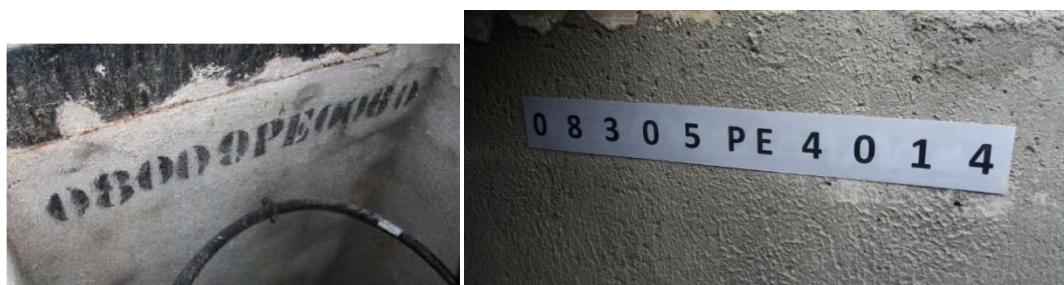
Ilustración 3. Ejemplos rotulado interior arqueta.
