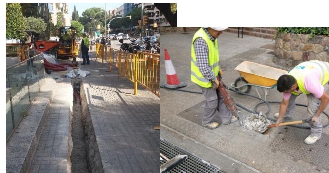
Ilustración 23. Ejemplos Canalización Convencional en ámbito municipal.
