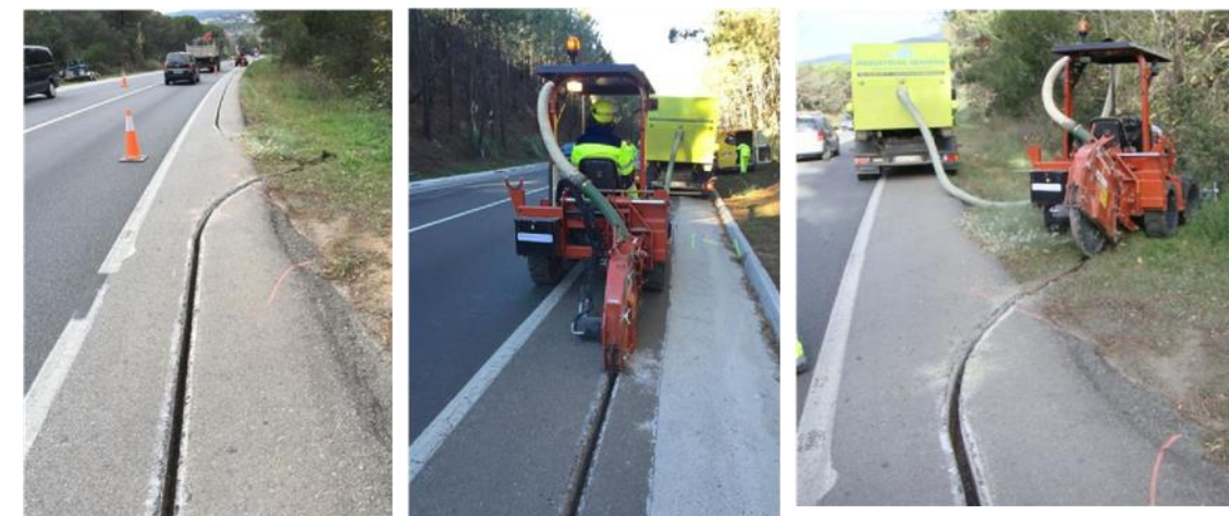
Ilustración 36. De izquierda a derecha: Ejemplo de microzanja; Ejemplo de trabajos en apertura; Giro de salida de la calzada por la microzanja, colocación de una arqueta.
