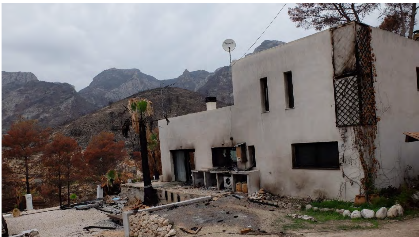
Imatge 8. Danys en un habitatge: el foc ha vençut els tancaments (finestres i portes) i n'ha cremat l'interior. Hi ha vegetació a la façana (plantes enfiladisses) i també al sostre (vol aeri d'arbrat). (Font: Medi XXI)
