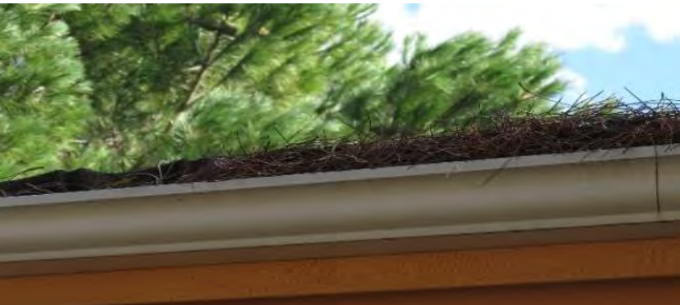
Imatge 28. Canaleta d'obra oberta. La caiguda de material incandescent (partícules de cendra) a sobre d'aquesta acumulació de fullaraca pot transmetre el foc a la teulada. És tan important la qualitat i el tipus de materials com el treball de manteniment que requereix un jardí. (Font: Medi XXI)
