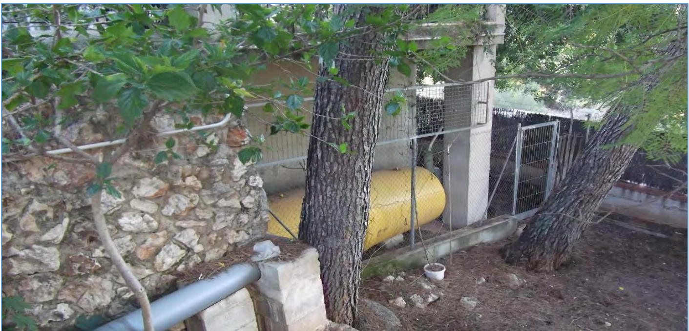
Imatge 52. Dipòsit de combustible annex a l'habitatge i sense unes mesures d'aïllament correctes. En cas d'explosió, les conseqüències són imprevisibles i catastròfiques. (Font: Medi XXI)
